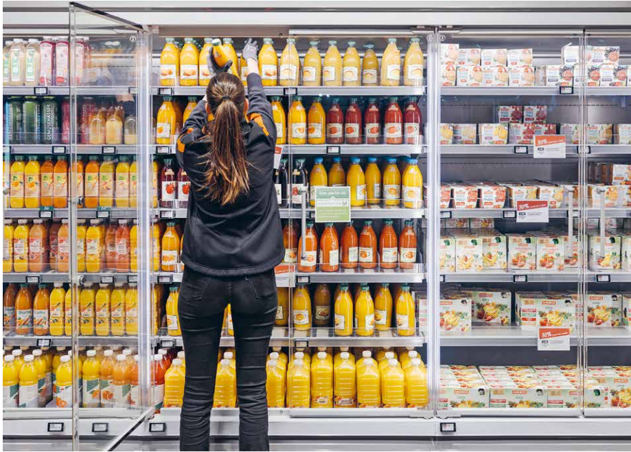
Optimal temperiert bis ins Kühlregal: Die Migros-Gruppe will komplett auf natürliche Kältemittel umstellen.
